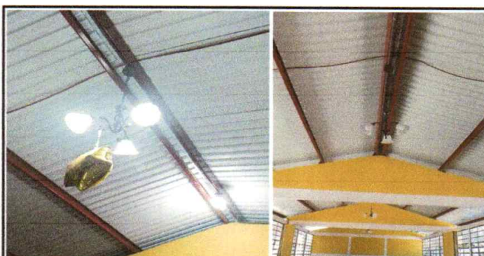
Foto 6: LÁMPARAS Y SISTEMA ELÉCTRICO INSTALADO
